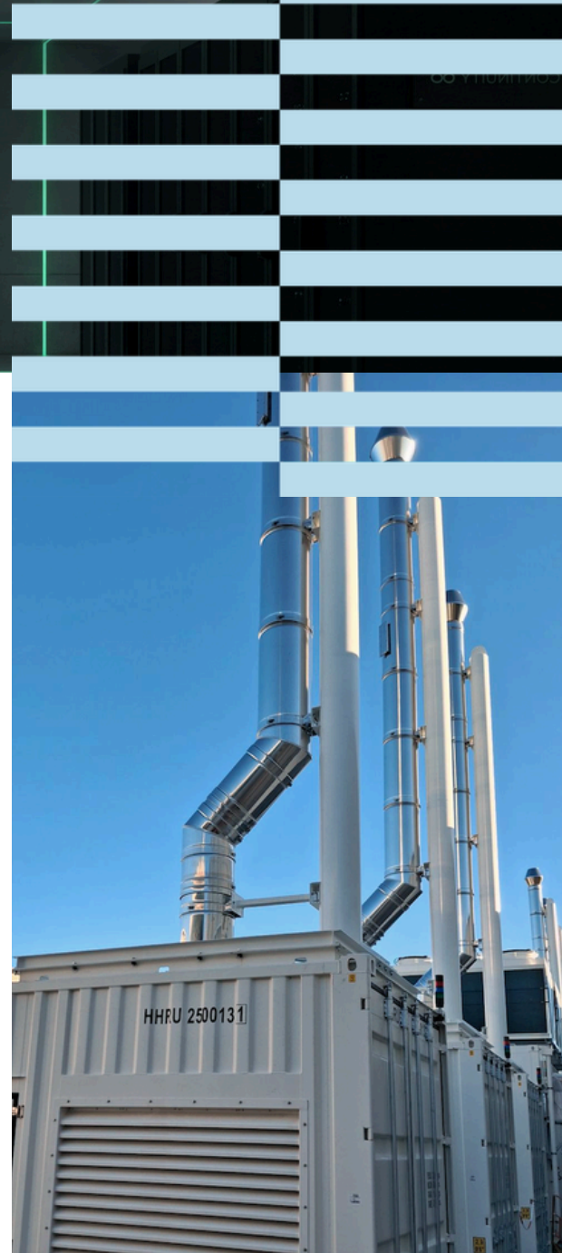
Modules Opcore HDD 1 MW PAR3-Ext.
